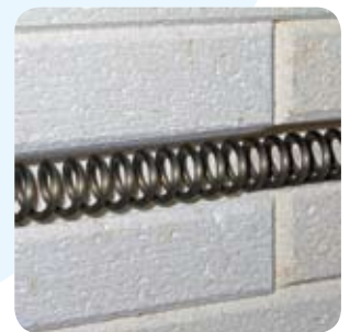
Resistenze montate su scanalature del rivestimento refrattario (KE-L e KE-N)
