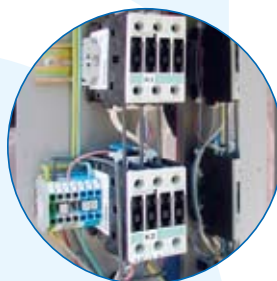
Cablaggio ben visibile a norma DIN/EN/VDE (normative elettriche tedesche standard)
